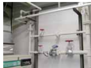
東京都水産加工工場、配管・壁
